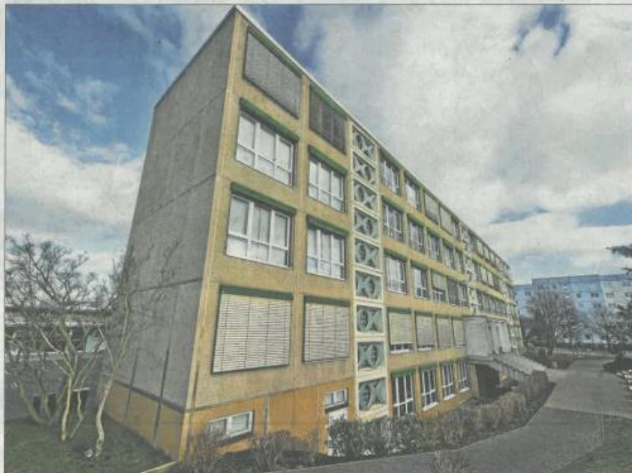
Schon lange wartet der Schulteil zwei des Salza-Gymnasiums in der Hannoverschen Straße auf eine grundlegende Sanierung. Dieses Jahr will der Kreis damit beginnen. Bis 2020 sollen 2,5 Millionen Euro investiert werden. Foto: Daniel Volkmann
